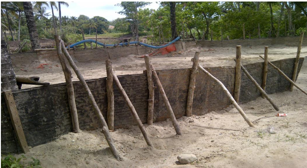
Gambar 3. Tempat Penampungan Pasir
